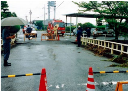
1-3-25 被災した北河原橋
