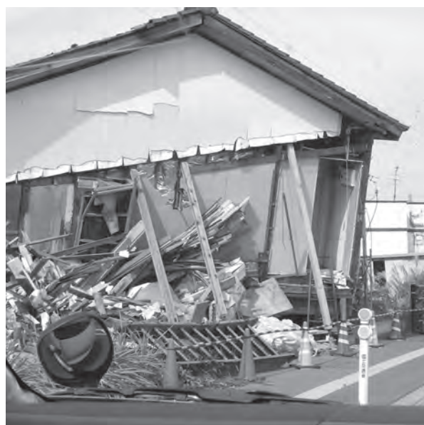
平成19年新潟県中越沖地震により（新潟県柏崎市内）
