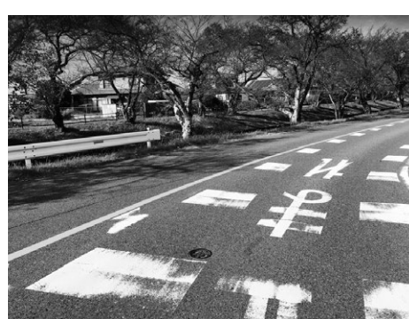
約3割の区間には転落防止のためのガードレールや柵がありません
