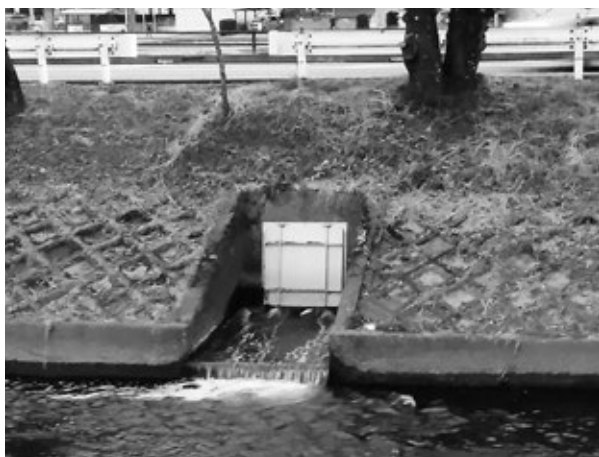
五条川に設置されているフラップゲート
