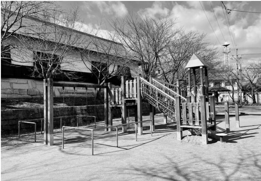
設置から年数が経ち、老朽化しているため更新を予定している小口城址公園の遊具
