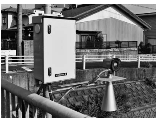
設置されている危険管理型水位計
