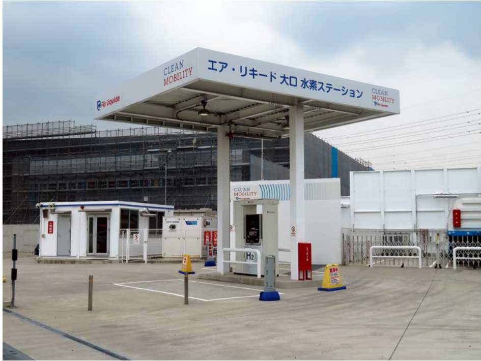
2-2-39 水素ステーション（大口町中小口三丁目地内）
