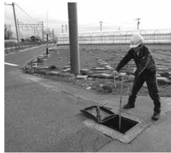
災害時緊急連絡管
