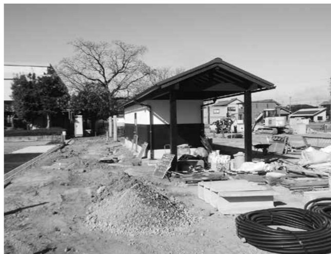
トイレの工事が進む多世代が集う憩い広場(旧北小学校跡地)
