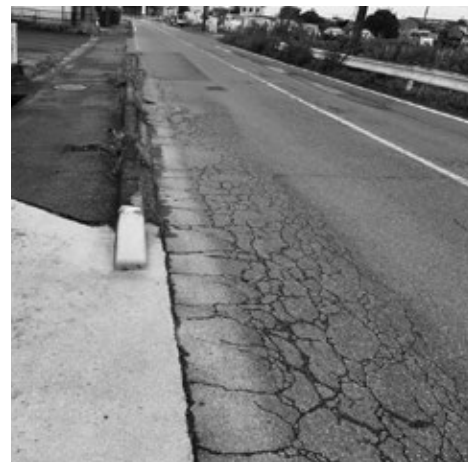
道路の損傷が激しく、時折、落雷のような大きな走行音が。 （豊田三丁目信号交差点 南側）
