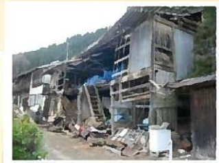
倒壊のおそれのある空き家
