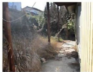
雑草が繁茂した空き家
